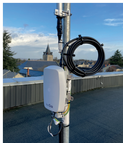
Déploiement d'une passerelle LoRa sur un toit terrasse
