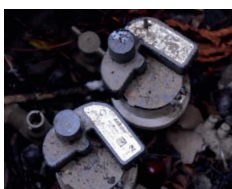
Compteurs d'eau communicants (têtes émettrices LoRa)
