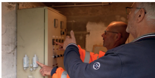
Vérification des capteurs des pompes de relevages à Pezou
