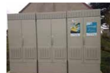
Armoire de montée en débit terminée
