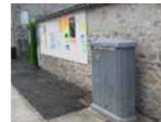
Choix de la localisation de la montée en débit (proximité SR)
